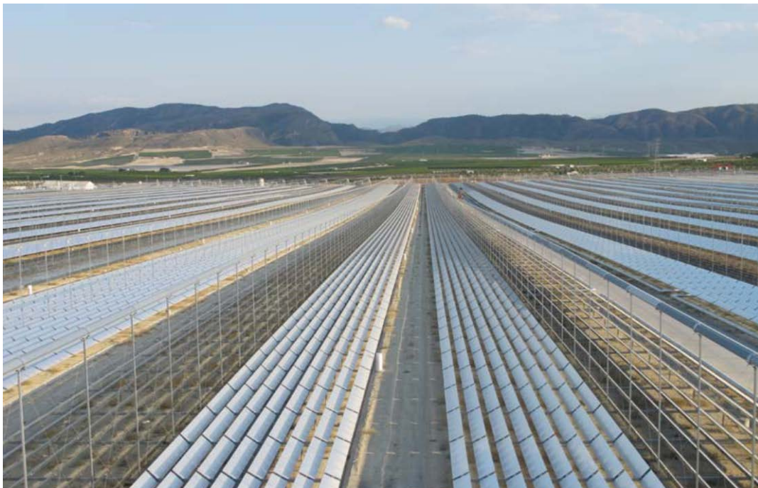
Figura 26. Figura 24: Vista del campo solar de la planta Puerto Herrado-II (Murcia, España).
