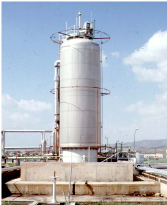
Tanque de almacenamiento en aceite
