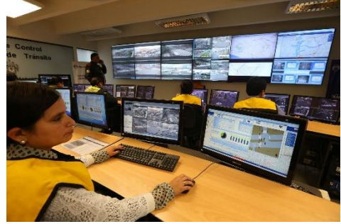
Ilustración 5: Centro de Control de tráfico 4
