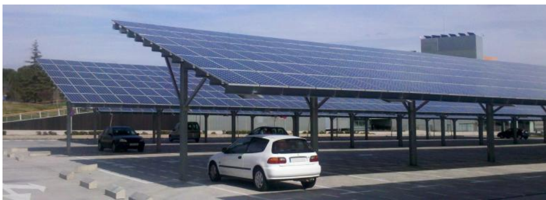
Imagen 1. Instalación fotovoltaica de la UAM
