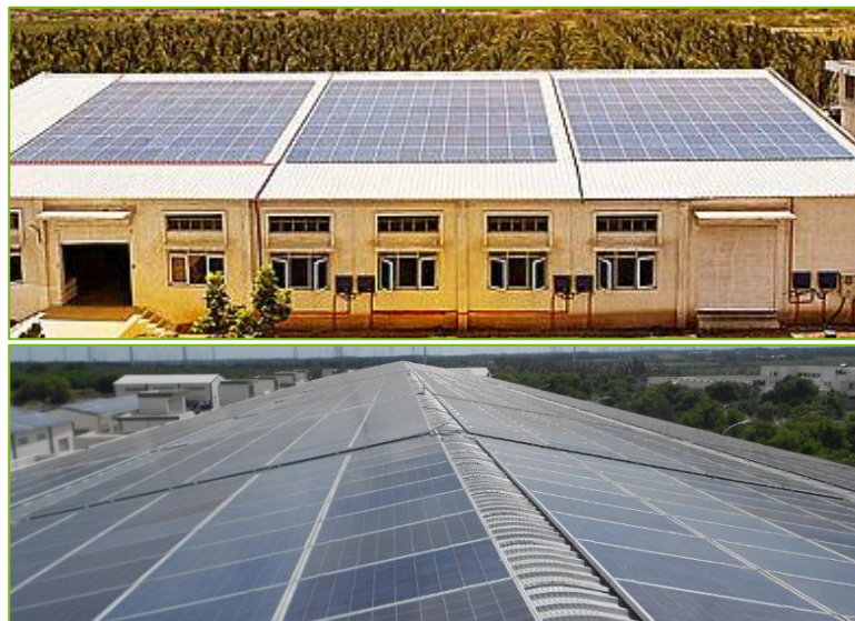
Imagen 31: Sistema fotovoltaico híbrido - Alpine Knits (Palladam, La India). Fuente: Canadian Solar | SMA Solar.
