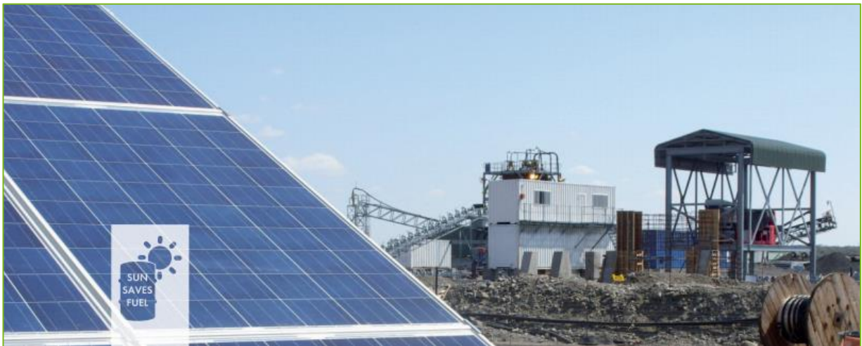
Imagen 34: Sistema fotovoltaico híbrido - Cronimet Chrome Mining SA, Thabazimbi (Sudáfrica). Fuente: SMA Solar.
