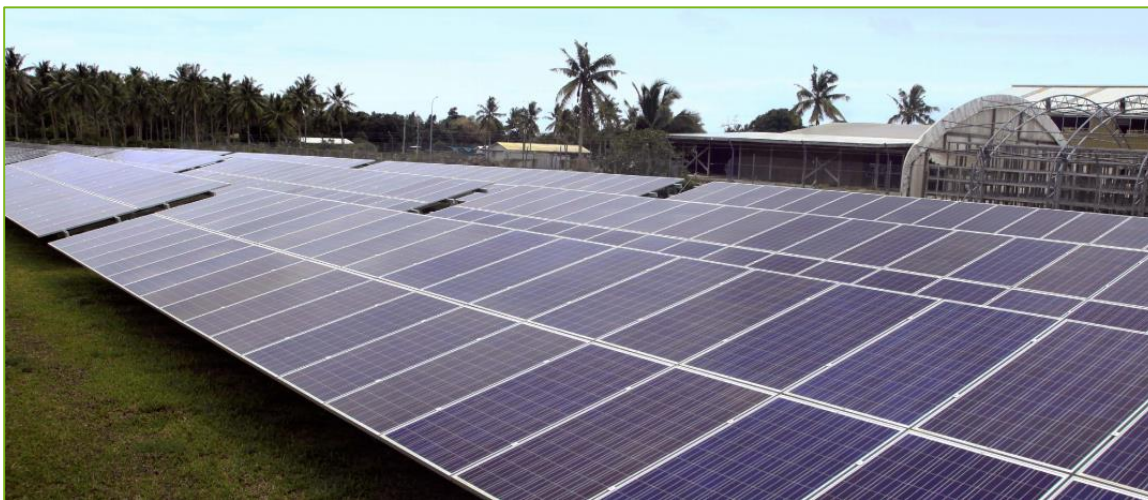
Imagen 32: Sistema fotovoltaico híbrido - Vava'u (Reino de Tonga). Fuente: SMA Solar.
