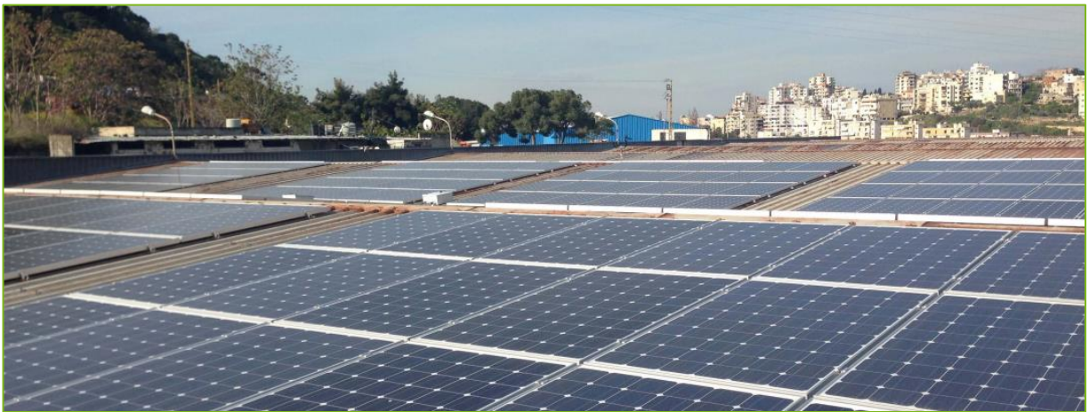
Imagen 33: Sistema fotovoltaico híbrido - API Plastics, Zouk Mosbeh (Líbano). Fuente: SMA Solar.
