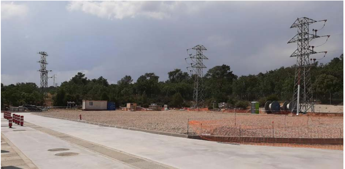
Imagen desde la propia subestación ST Aranda (Burgos). Fuente: Propiedad Iberdrola
