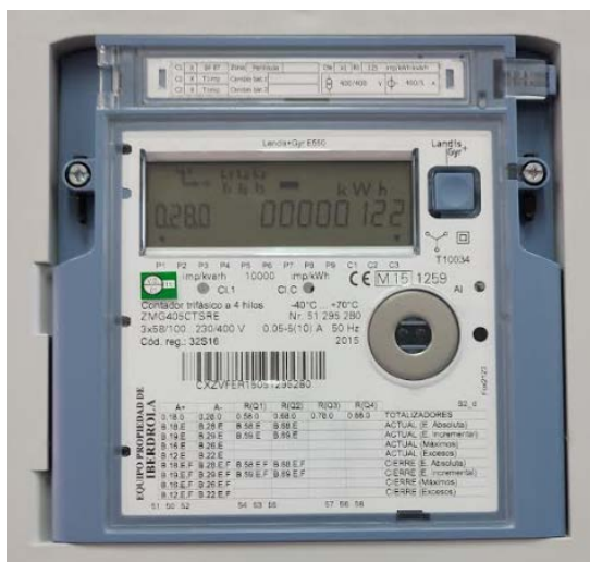
Imagen del contador de la ST Renedo (Valladolid). Fuente: Propiedad Iberdrola
