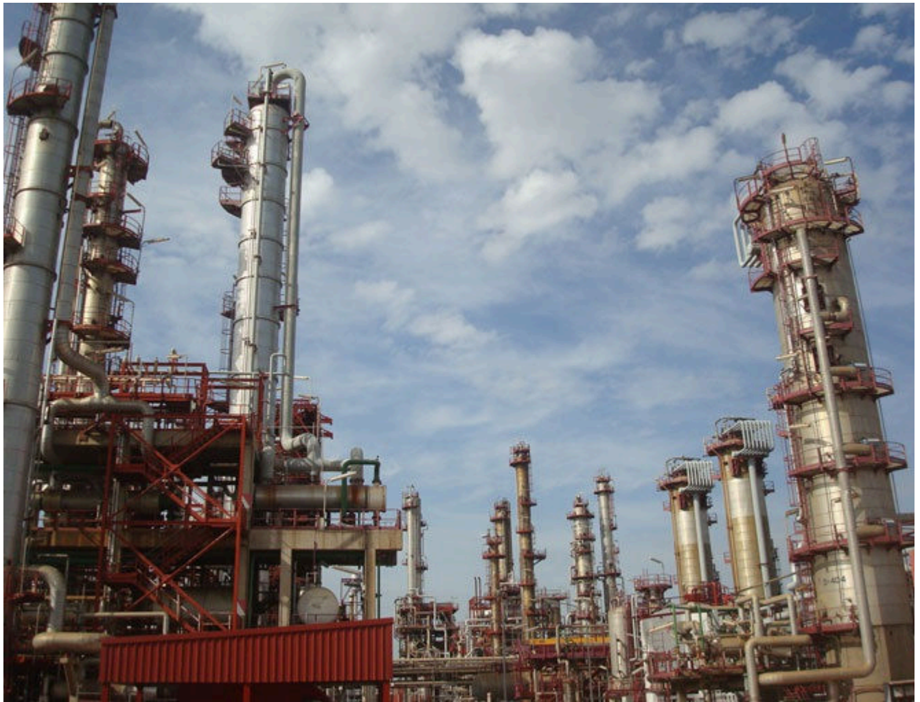
Instalaciones de la refinería 'La Rábida'.
