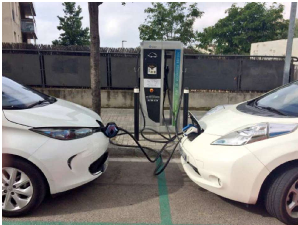
Punto de recarga para coches eléctricos en Mataró. / AYUNTAMIENTO DE MATARÓ
