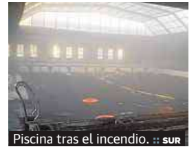
Piscina tras el incendio. :: SUR
