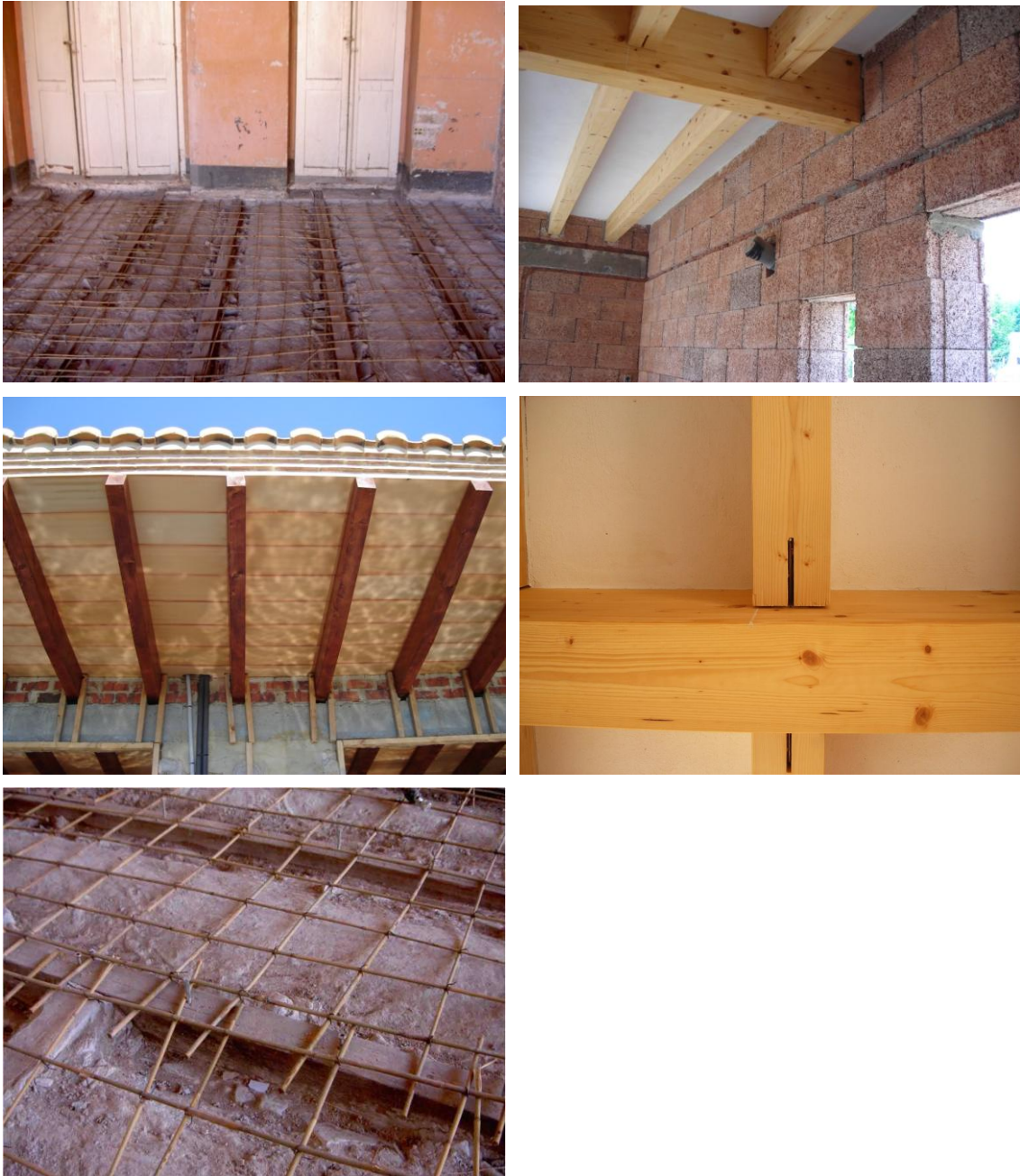
Sistema constructivo mediante estructuras de madera y de mallazo de bambú.
