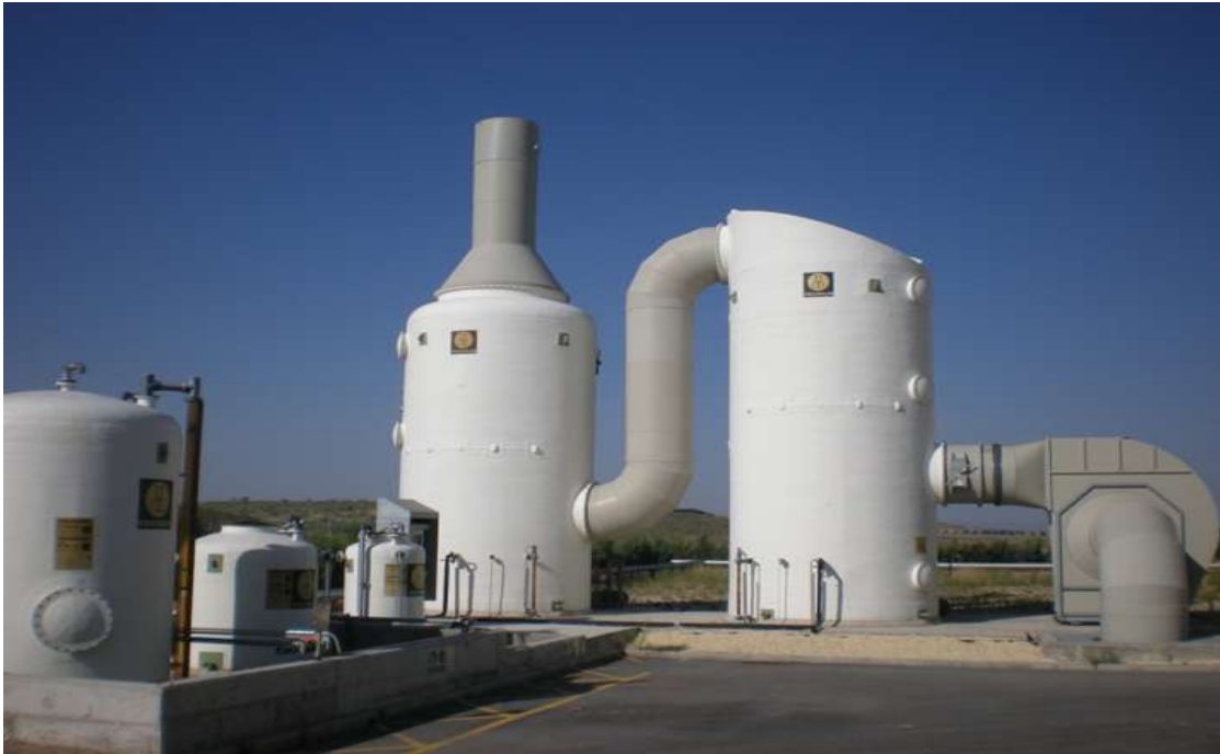
Desodorización vía química. Cubetos reactivos a la izquierda
