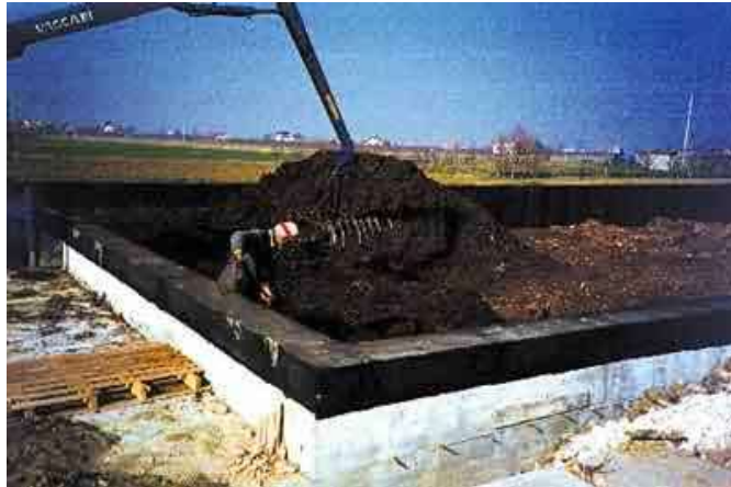
Adecuación de un filtro biológico
