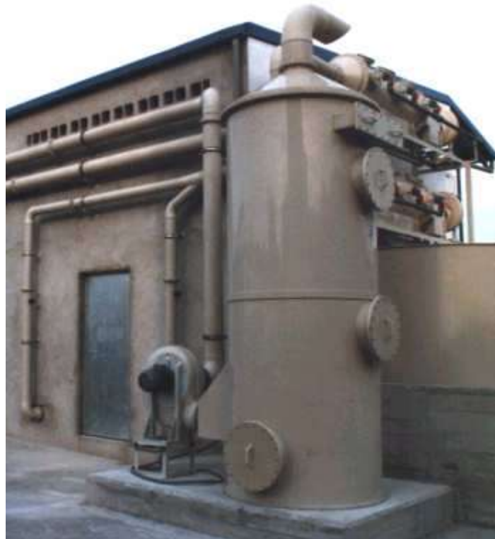
Torre de carbón activo
