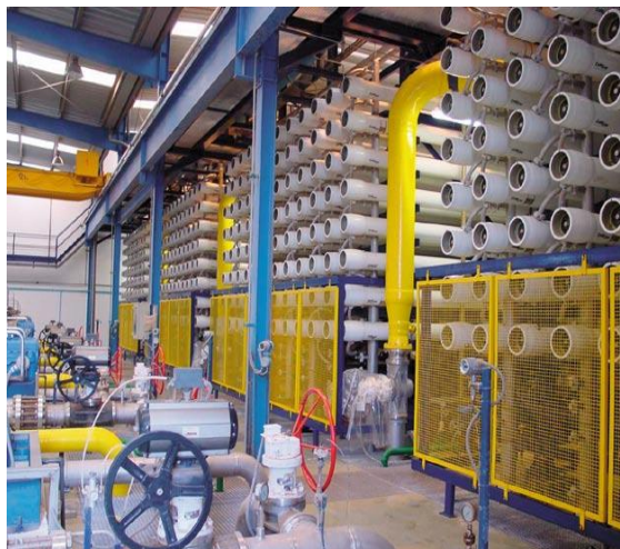
Aspecto general del interior de una desaladora de osmosis inversa. Imagen cortesía de INALSA
