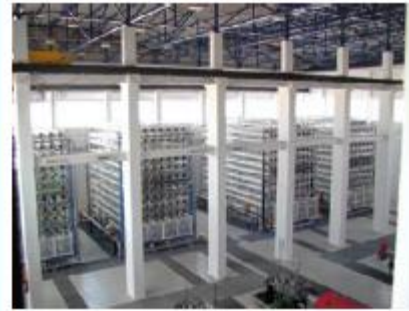
Figura 31. Vista general de una desaladora II. Por cortesía de AEDYR
