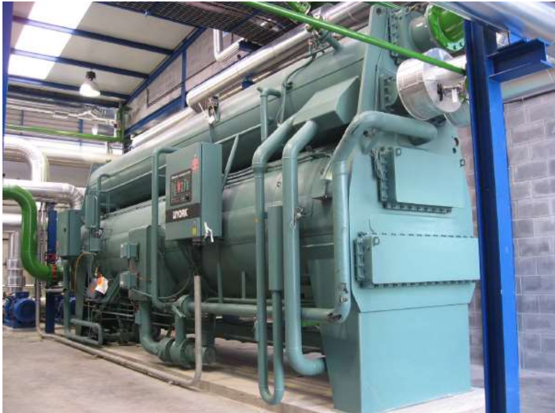
FIG. 6.8 MAQUINA DE ABSORCIÓN DE BROMURO DE LITIO. CORTESÍA DE YORK
