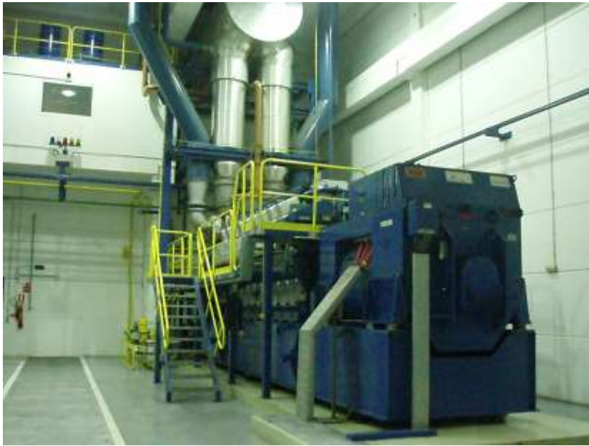
FIG. 4.2. MOTOR DE GAS DE MEZCLA POBRE DE 3 MW
