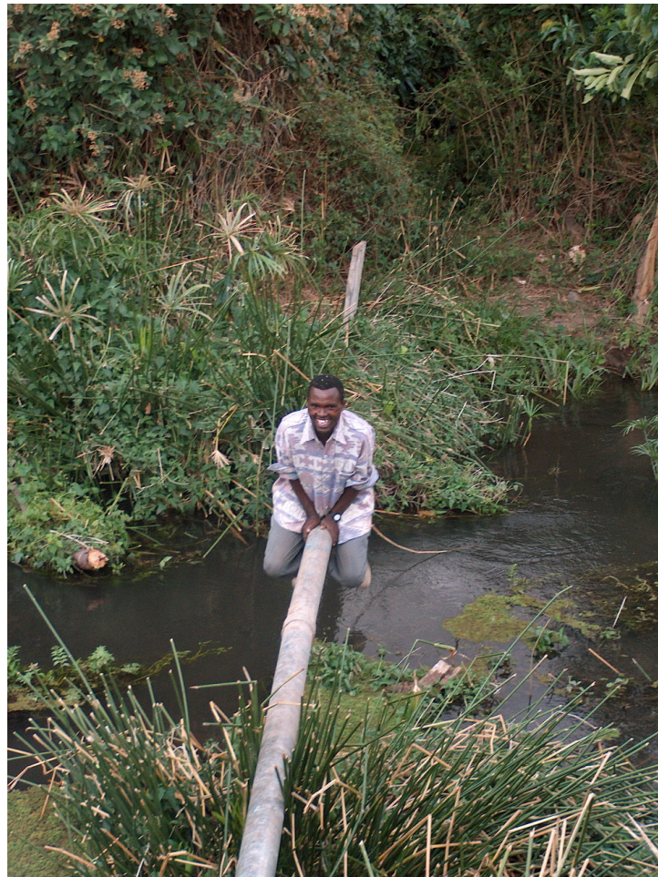
Tubería de alimentación al ariete de Barazani-Tanzania-Ingeniería sin Fronteras
