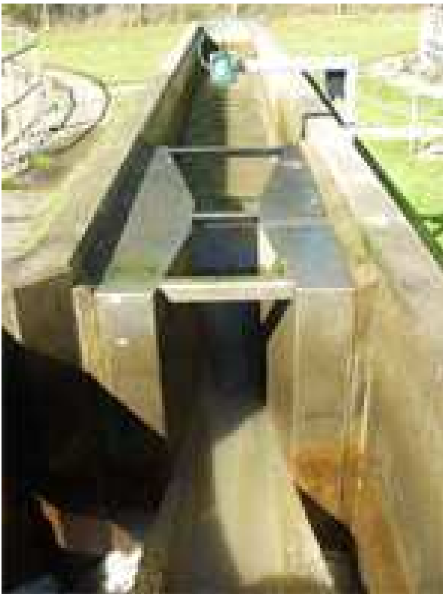
Vista de un medidor de caudal en canal tipo Parshall.
