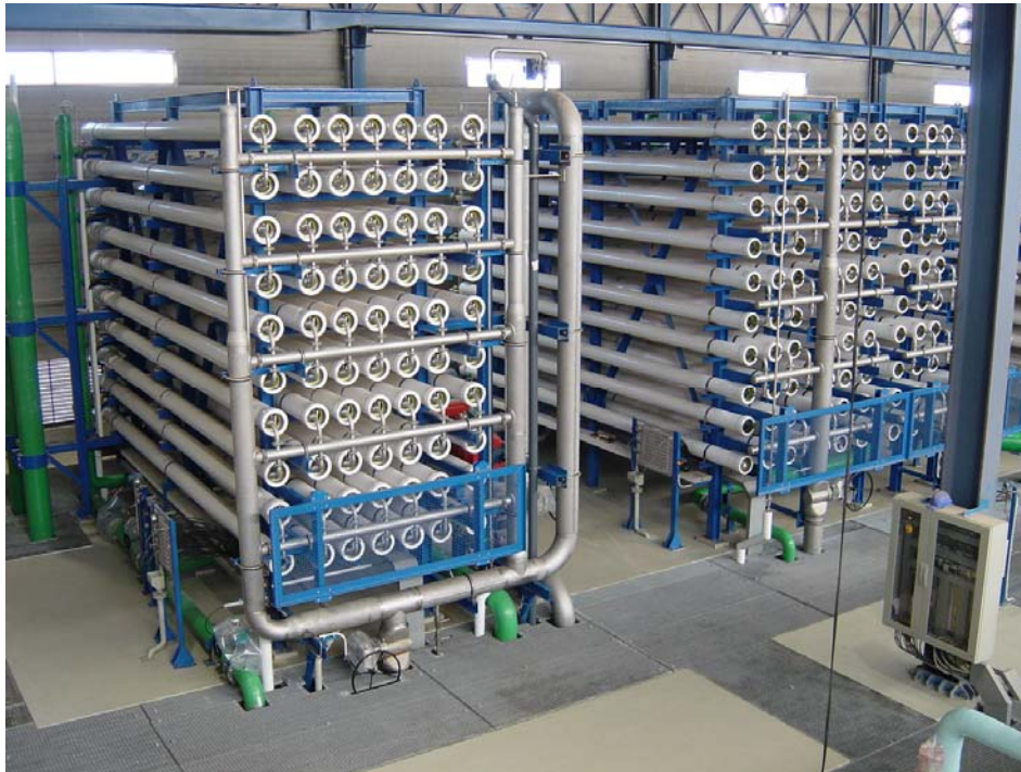
Gráfico 3 – 8 bis Foto bastidores de una desaladora de doble etapa
