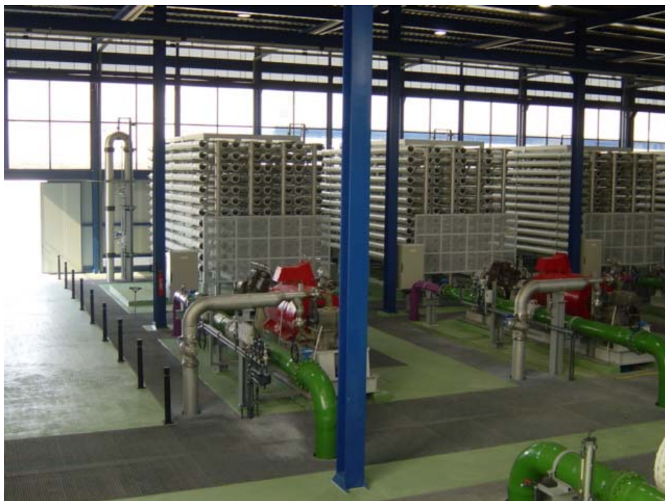
Gráfico 3 – 8 - 1 Foto bastidores de una desaladora de una etapa
