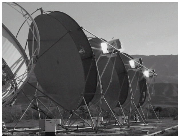
Figura 23. Vista lateral de las tres unidades DISTAL-II de la PSA, fabricadas por la empresa alemana Steinmüller y con el motor SOLO 161 solar en el año 1996. Cada unidad tiene un diámetro de 8,5 m y una potencia eléctrica bruta de 10 kW.
