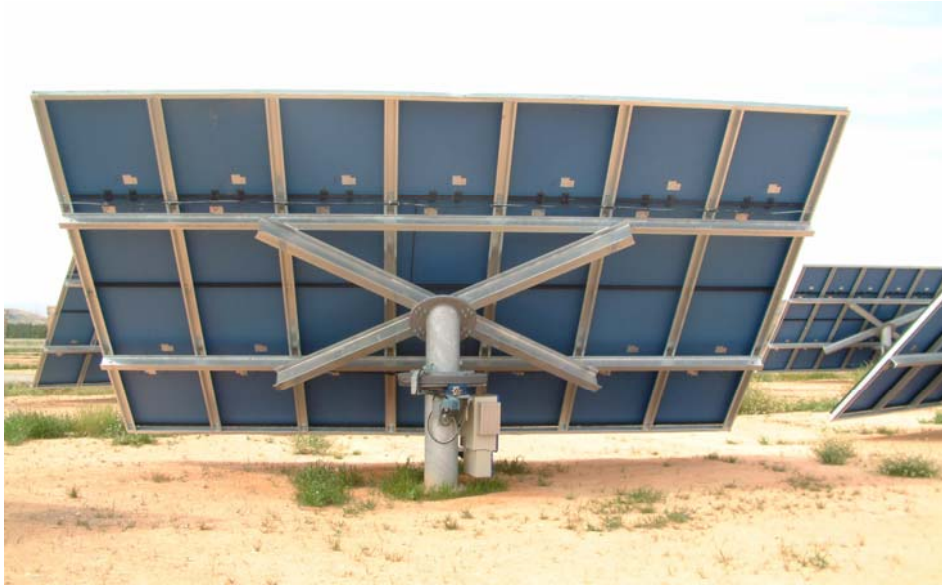
Figura 25. Seguidor de la zona distribuida de la planta fotovoltaica Montes del Cierzo en Tudela.
