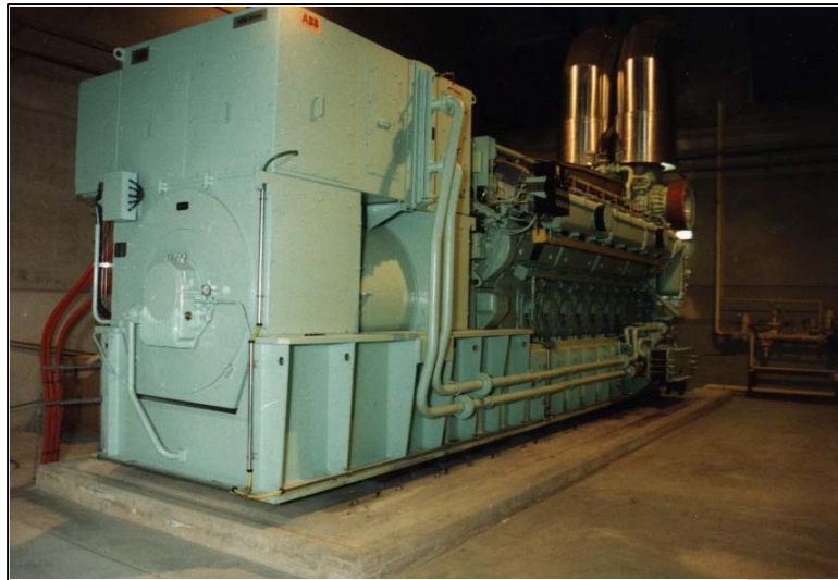
FIG. III.1. MOTOR DE GAS DE MEZCLA POBRE DE 3 MW
