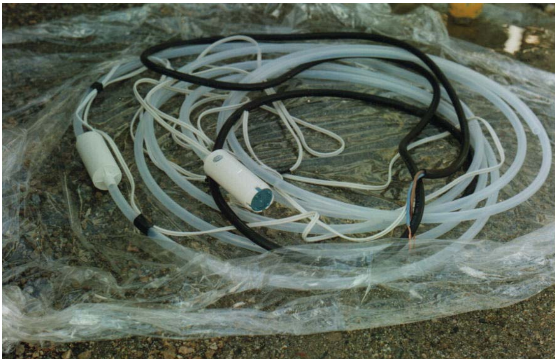
Figura 8.- Sistema de extracción de aguas subterránea compuesto por dos bombas sumergibles con motor eléctrico en serie
