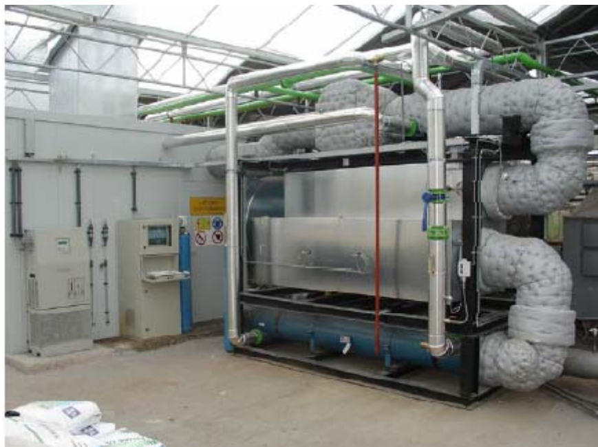
Figura X4. Aspecto de la sala de máquinas
