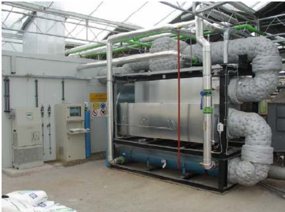
Aspecto de la sala de máquinas
