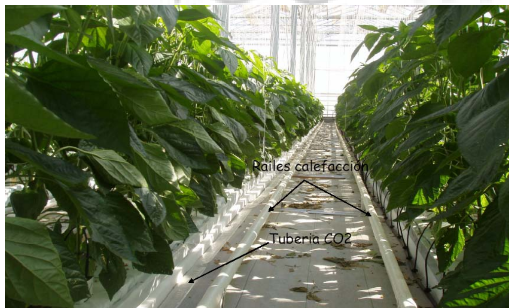
Figura X4. Calefacción por raíles y distribución de CO 2
