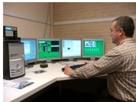
2. Sistema de monitorización y control de la planta suministrado por el proveedor.
