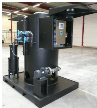
1. Unidad de control del pH instalada para monitorizar el sistema
