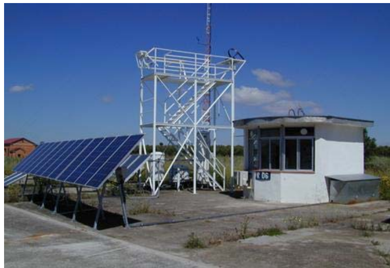
Figura 2-17 : Instalaciones de HIDROSOLAR H 2
