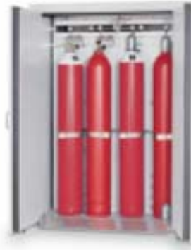
Figura 5-3 : Botellas de almacenamiento de hidrógeno
