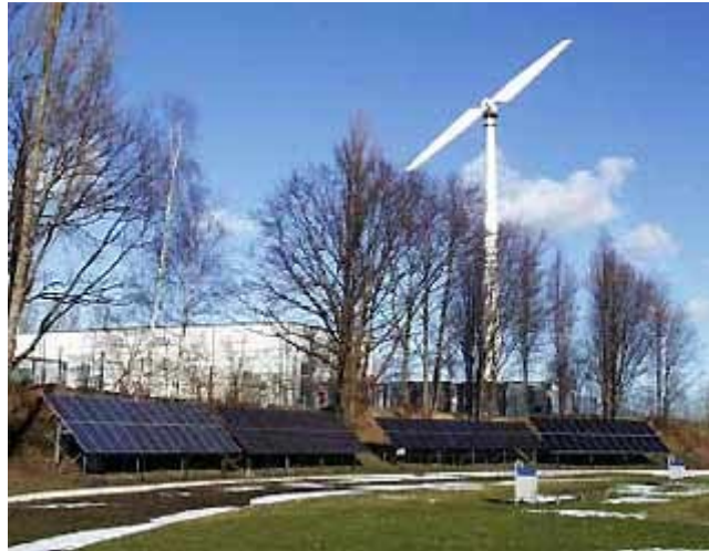
Figura 2-8 : Instalaciones de generación de hidrógeno en Stralsund
