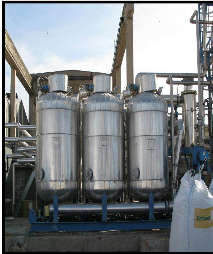
Fotografía 7 - Tanque de criogenización de gases.
