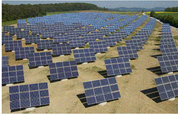
Figura 2. Campo de placas Solares
