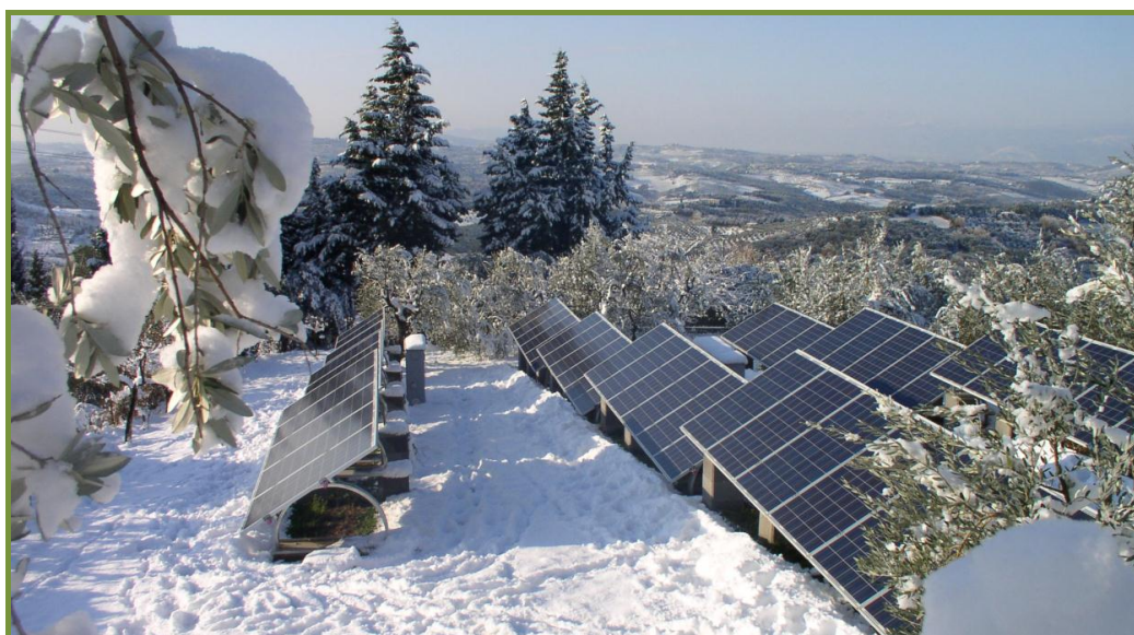
Figura 67: Ejemplo colocación de placas fotovoltaicas en alta montaña
