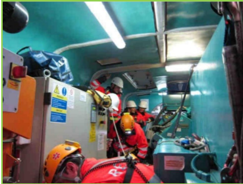
Figura 109: Imagen interna de un aerogenerador.
