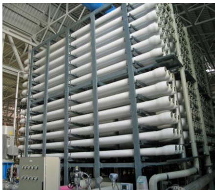
Bastidor de ósmosis inversa.
