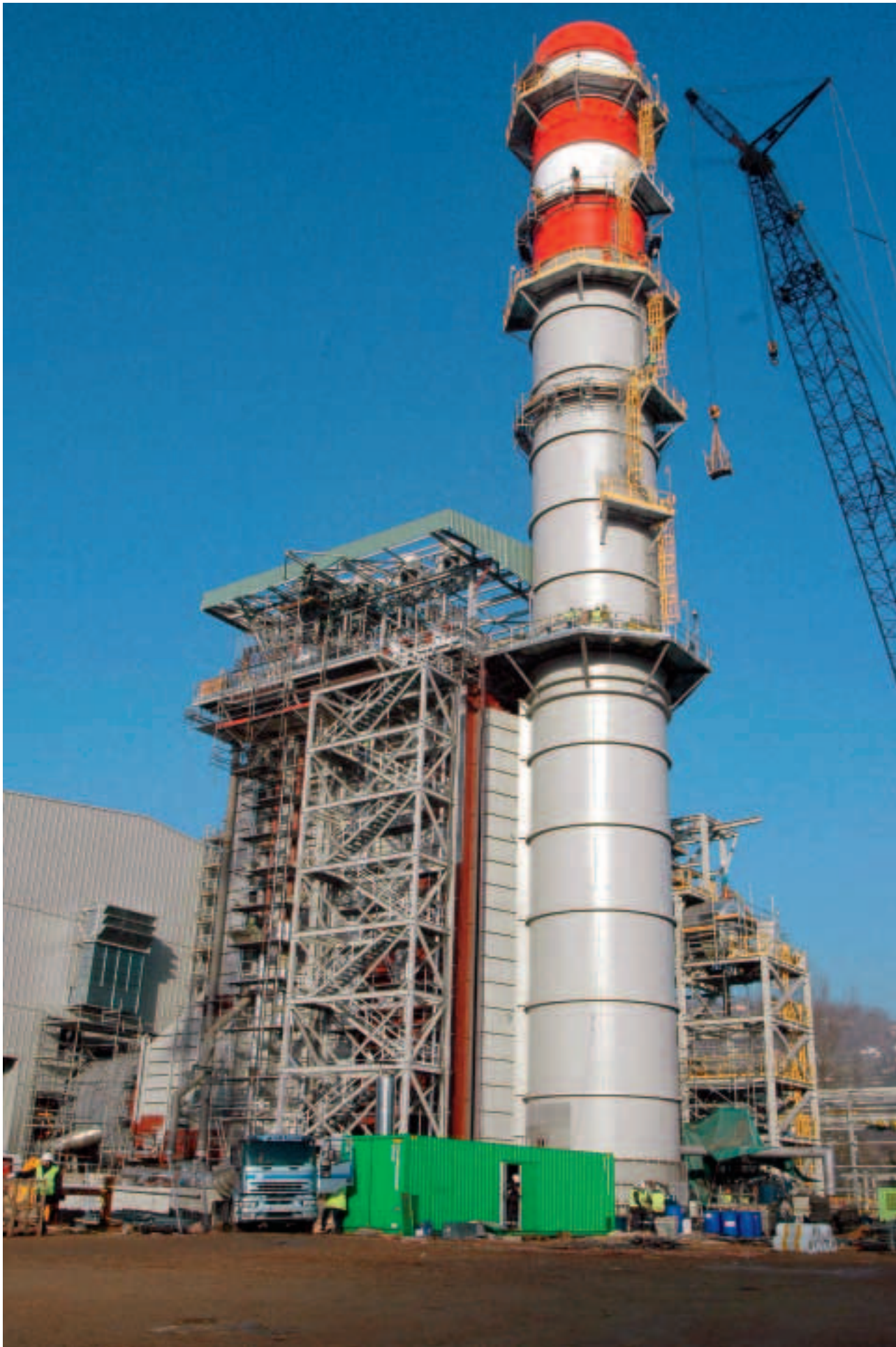
Paisaje industrial. Vista de la planta de ciclos combinados de Hidrocantábrico, construida en Soto de Rivera. Asturias, 2007
