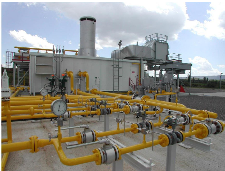
Ilustración 53: Cabina de un compresor, en la parte superior se puede observar el sistema de venteo.
