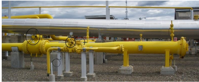
Ilustración 31: Trampa rascadores de la planta de Serrablo.
