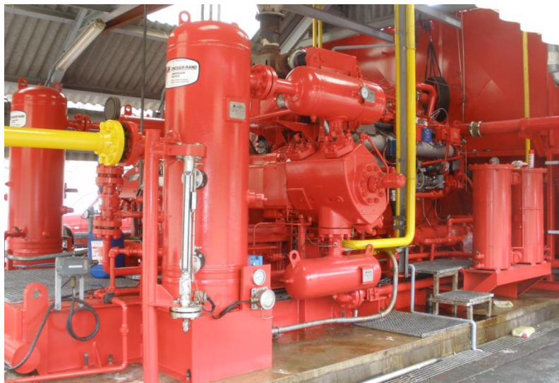
Ilustración 34: Motocompresores a gas de los pozos de Aurin en Serrablo (funcionan por pistones).
