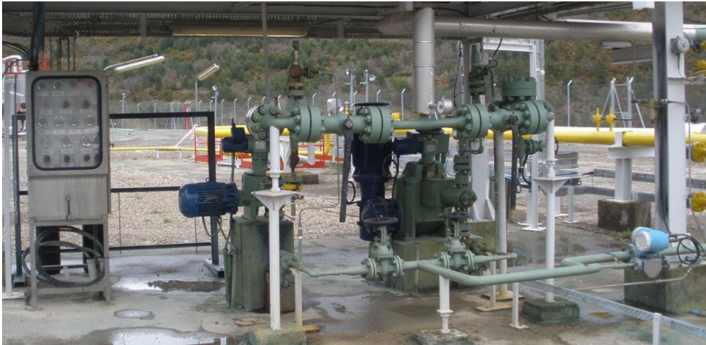
Ilustración 37: Sistema de inyección de metanol en Serrablo.
