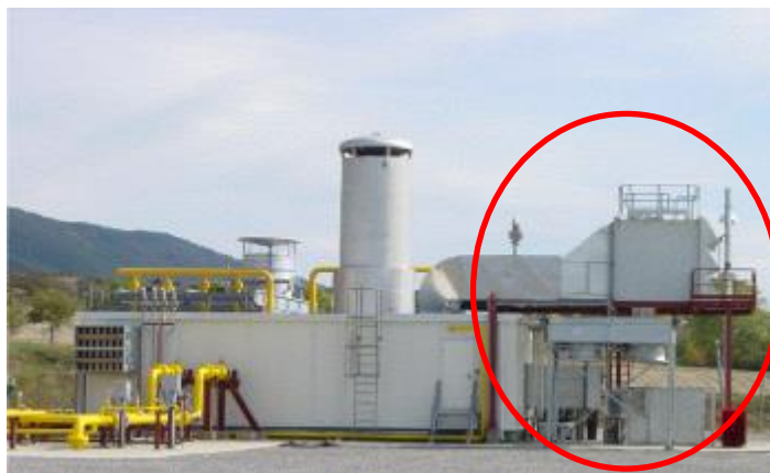
Ilustración 36: En el círculo rojo de la imagen vemos el aerorrefrigerador de un turbocompresor de Serrablo
