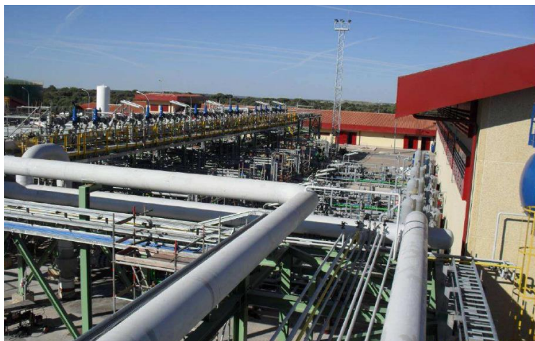
Ilustración 42: Rack de tuberías de Yela.
