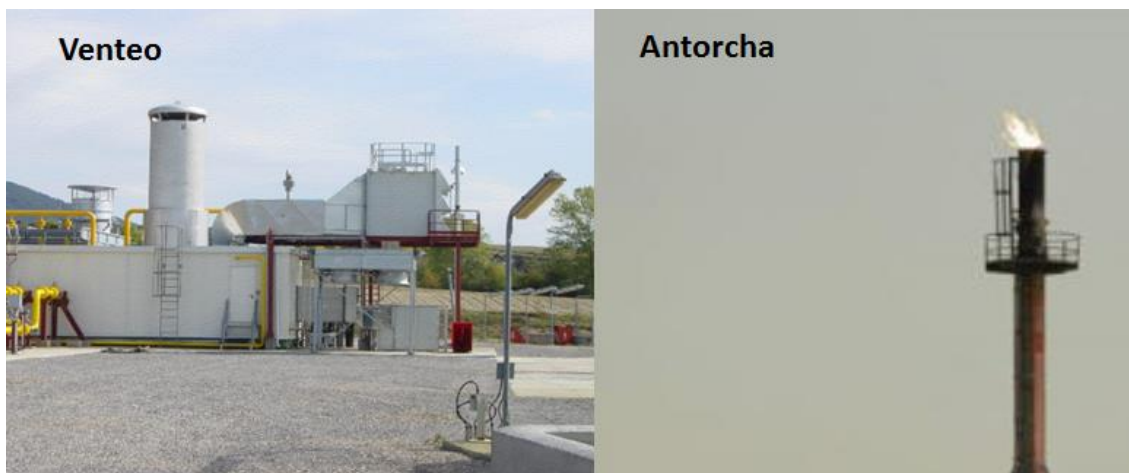
Ilustración 44: Sistema de seguridad: Venteo (Izq.) y Antorcha (Der.).
