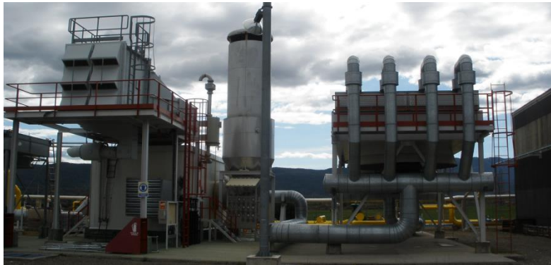
Ilustración 33: Turbocompresor Booster de Serrablo.
