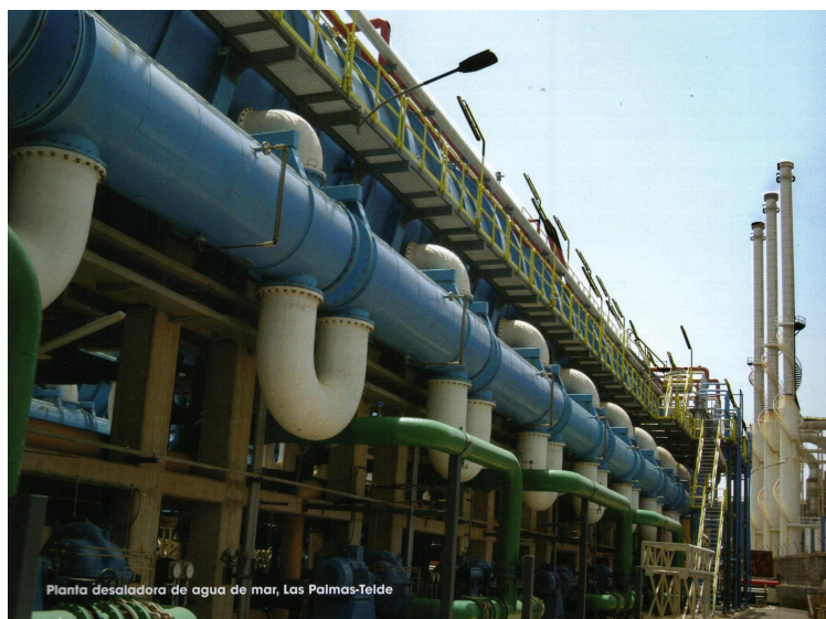
Planta desaladora de Las Palmas-Telde (proceso MSF)
